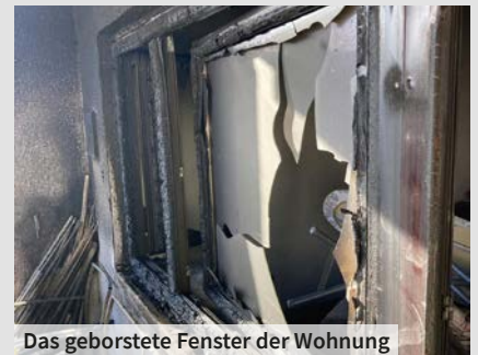
Das geborstene Fenster der Wohnung
