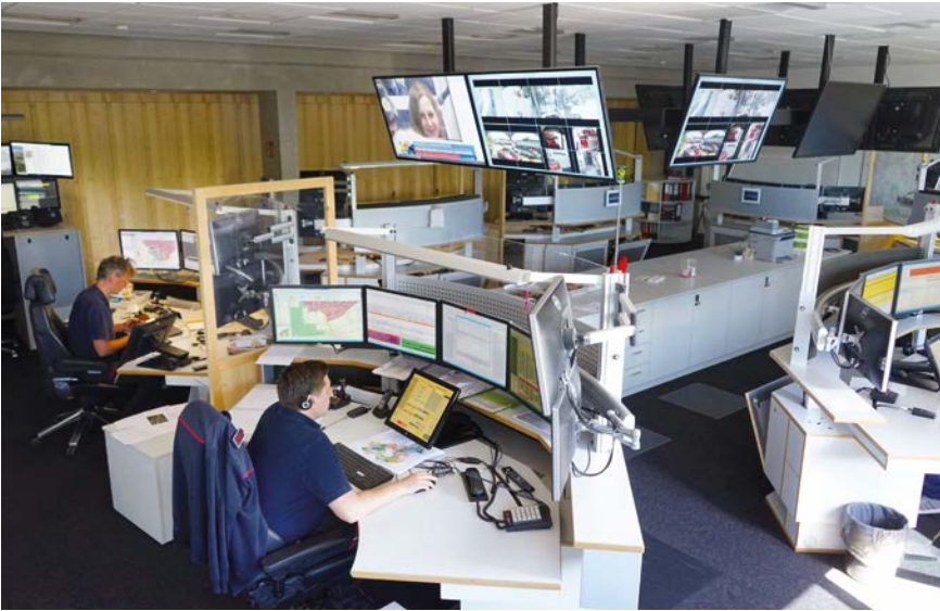
Blick in den Betriebsraum der Integrierten Leitstelle
