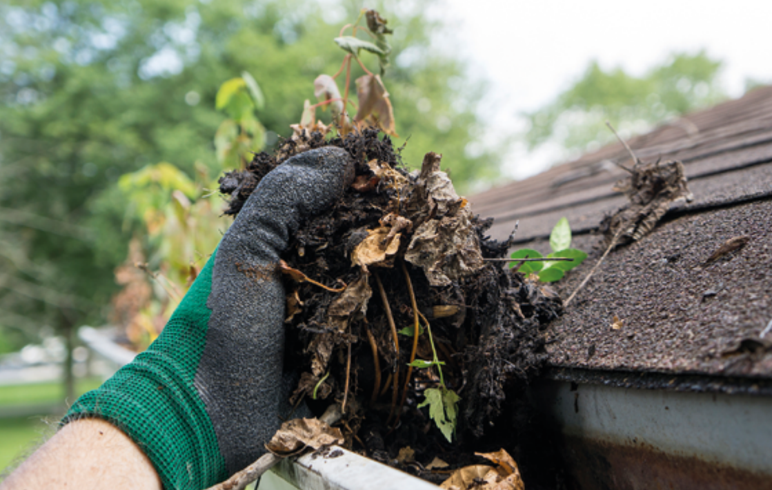
Abb. 22: Dachrinnen sollten immer frei durchlässig sein.
